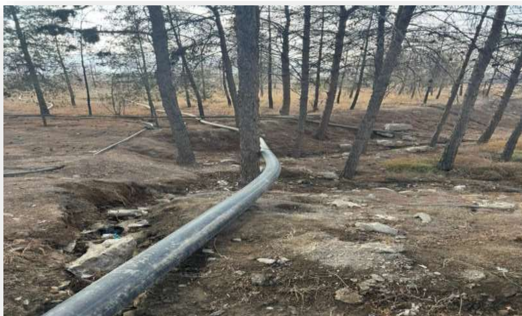
کنترل آب سرریز استخر جنب اداره قدیم با لوله کشی مناسب
